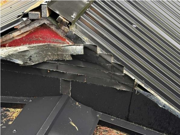
Bild 1: Förråd utvändigt, Tak, Hål i taket på gaveln mot huset, saknar plåt. Se fortsatt teknisk utredning
