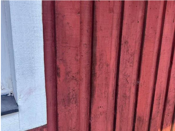
Bild 1: Utvändigt, Fasad, Färgsläpp på fasaden
