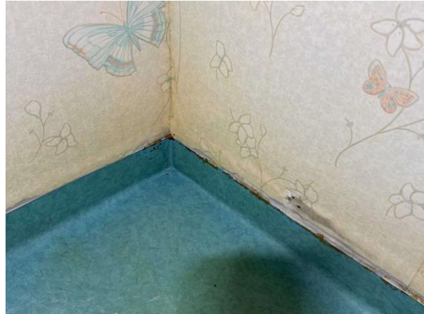
Bild 2: Invändigt, Entréplan, Väggmattan har börjat släppa i duschen, tekniska livslängden har passerat. Badrummet bör bytas, S...
