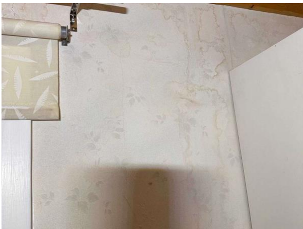
Bild 3: Invändigt, Entréplan, Lite fuktrosor på vägg se fortsatt tekniskt utredning
