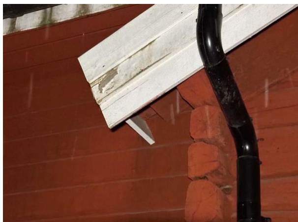
Bild 1: Utvändigt, Fasad, Färgsläpp på foder, vindskivor
