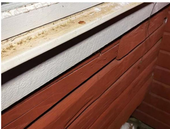
Bild 2: Utvändigt, Fasad, Färgsläpp på foder, vindskivor
