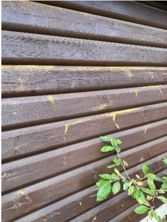
Bild 1: Utvändigt, Fasad, Lite färgsläpp på fasad samt vindskivor
