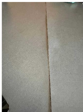
Bild 2: Invändigt, Entréplan gäst lägenhet, Bänkskiva har svällt i kanterna pga att bänkskivan tandar i skarven och fukt tränger in, se riska...
